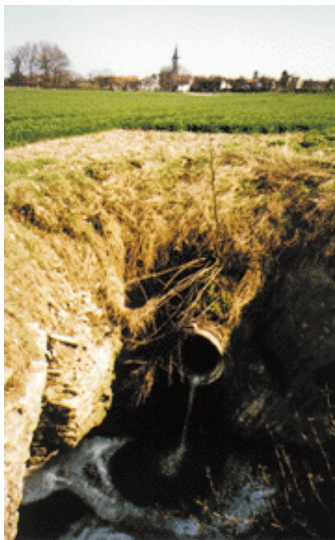
Photo 11 Rejet direct et localisé d'eaux usées dans le karst (88)
